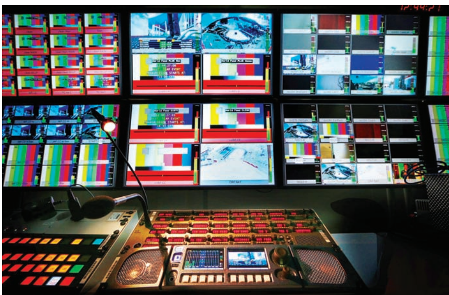
Оборудование Riedel, установленное в Международном вещательном центре
